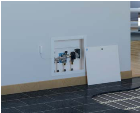
LK Minisekoitusryhmä M60 asennettuna LK Seinään upotettavaan kaappiin M60 VT.
