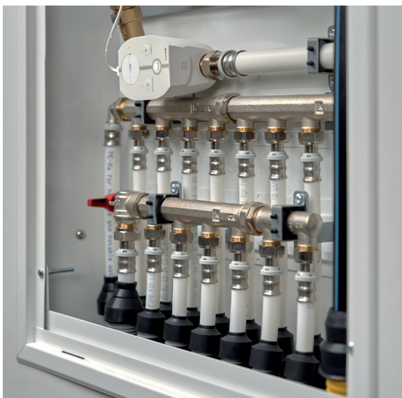
Vattenfelsbrytaren monterad i skåpet.
