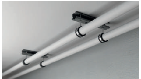
Exempel klamring vid horisontell montage.
