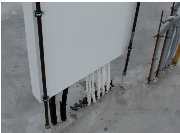
Monterat skåpstativ L2.
