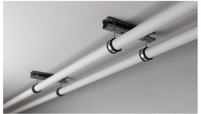
Exempel klamring vid horisontell montage.
